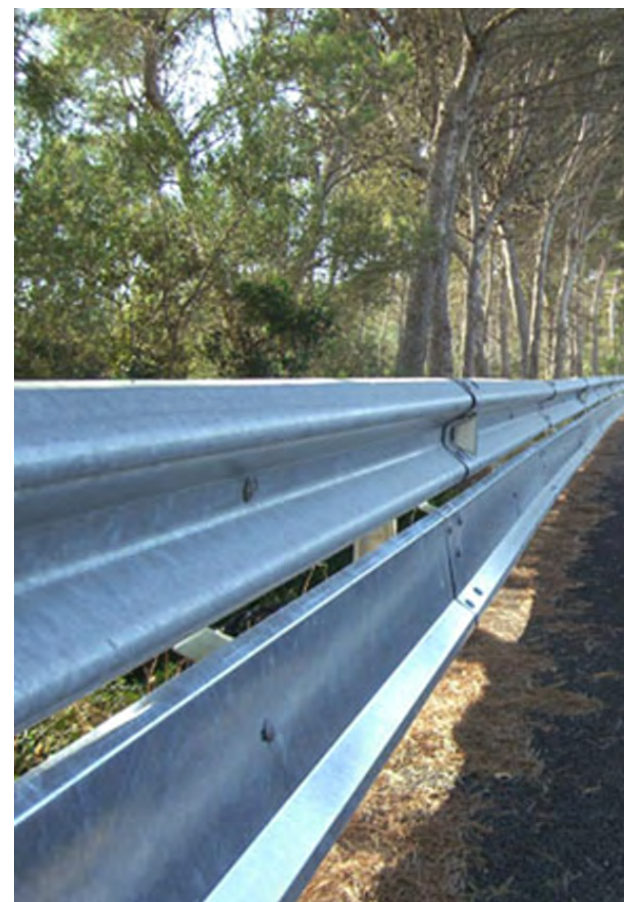
Barrera de contención GIVASA; empresa española de seguridad vial.
